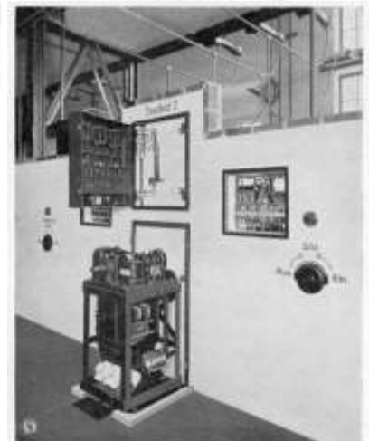
Bild 14. 50 kV-Ölschalterantrieb (Blechhaube abgenommen), Siemens-Westinghouse-Schutz darüber aufgeklappt, Klemmenleistensuche, Trennschalterantrieb mit Stellungslampen.
