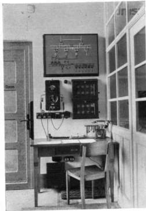
Abb. 47. Warte des Umspannwerkes Weimar mit Blindschaltbild, Gefahrmeldeklappenschrank, Post- und Betriebsfernsprecher.
