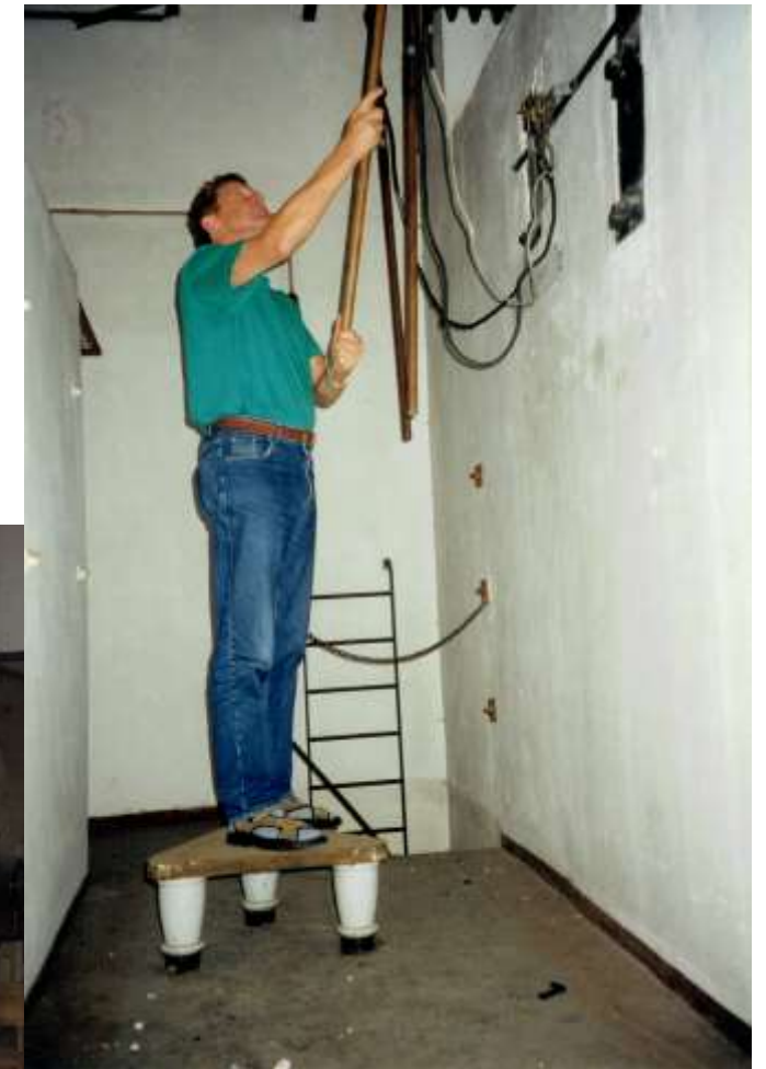
Lutz Riede Erden und Kurzschließen in SSt Cabarz
