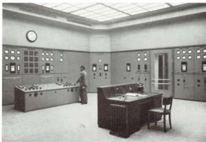
Schaltwarte des Kraftwerks und Umspannwerks
