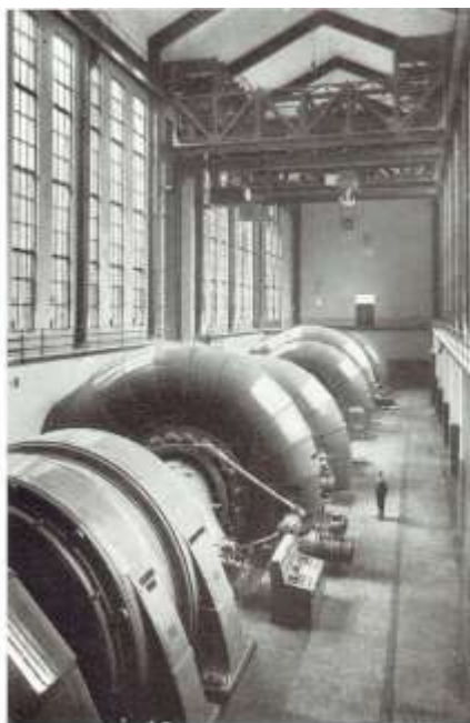
Maschinenhalle des Kraftwerks
