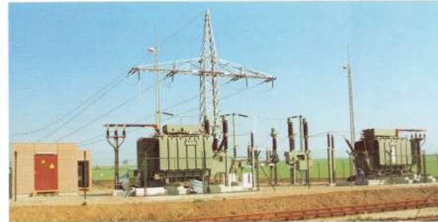
Bild 3: Unterwerk Neudietendorf und 110-kV-Bahnstromleitungsanschluß.
