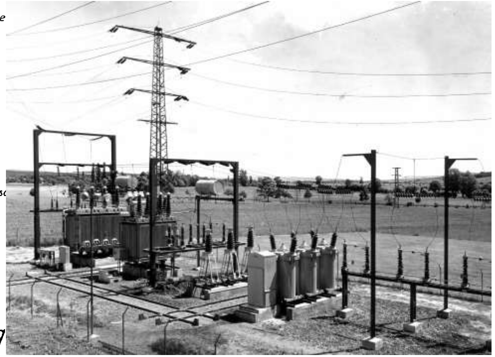
UW Bleicherode, 110-kV-Anlage errichtet 1929/30
