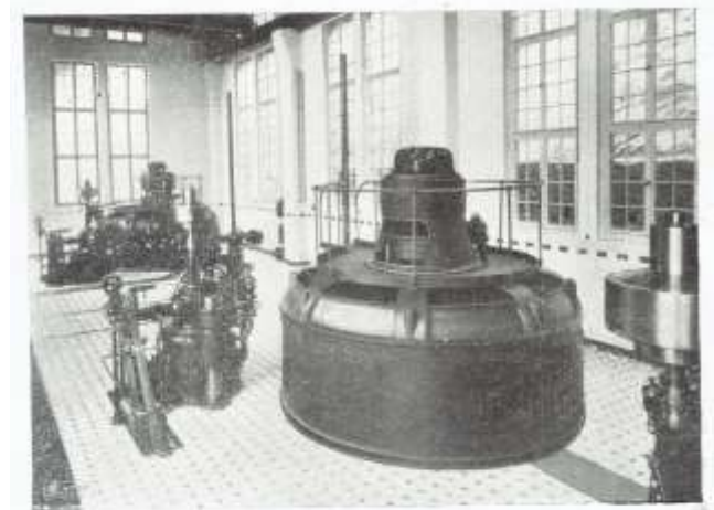
Abb. 25. Maschinensaal im Kraftwerk Ziegenrück.
