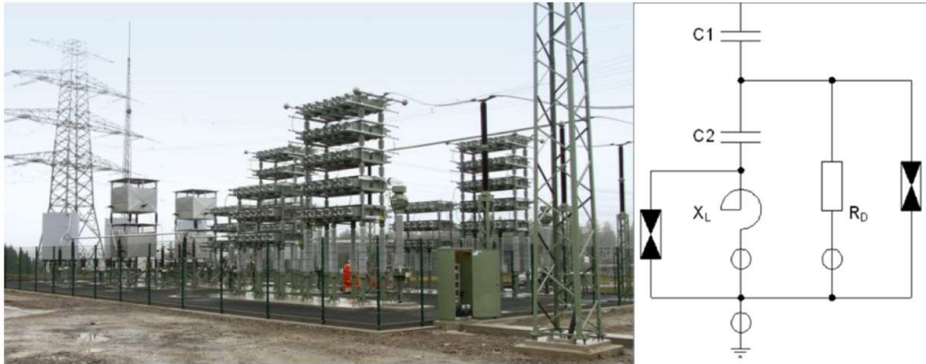
Bild 44: 380-kV-MSCDN 200 Mvar UW Altenfeld (links) und single line (rechts) C – Kondensatorbatterien, X L – Drosselspule, R D – Dämpfungswiderstand u. Überspannungsableiter © 50Hertz
