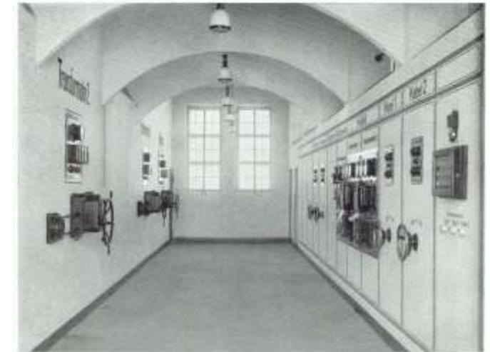
Abb. 46. Bedienungsgang des Umspannwerkes Apolda. Sämtliche Öl-schalter besitzen Handantrieb.
