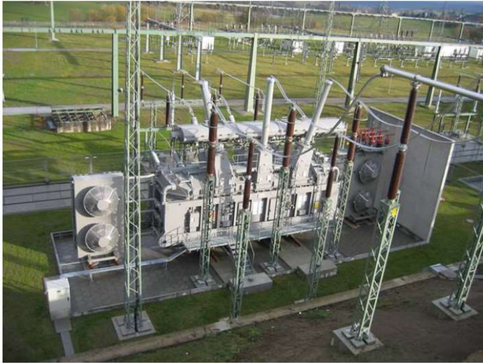
Bild 34: 400-MVA-Transformator 380/220(110) kV im UW Remptendorf © VE Transmission
