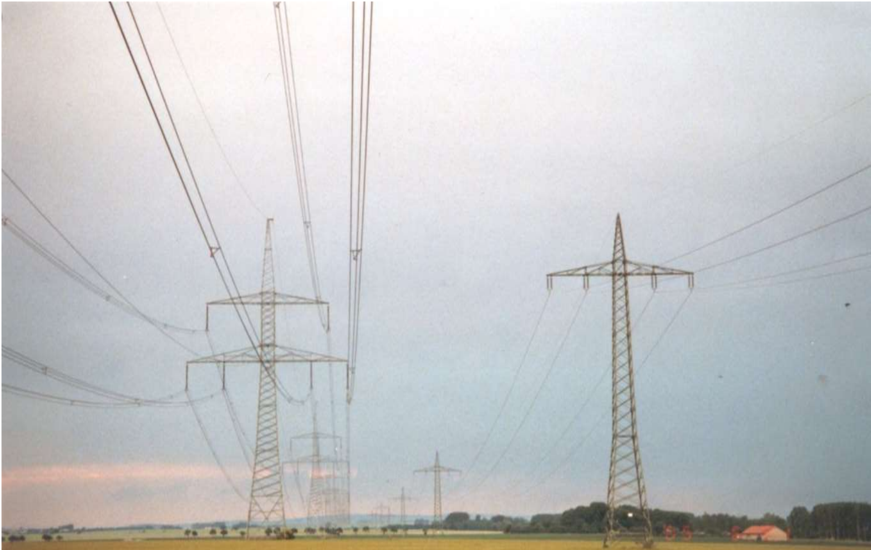
Leitungen der Wiedervereinigung, Nähe Gotha, 380 kV, 50 Hz und 110 kV, 16\frac{2}{3} Hz
