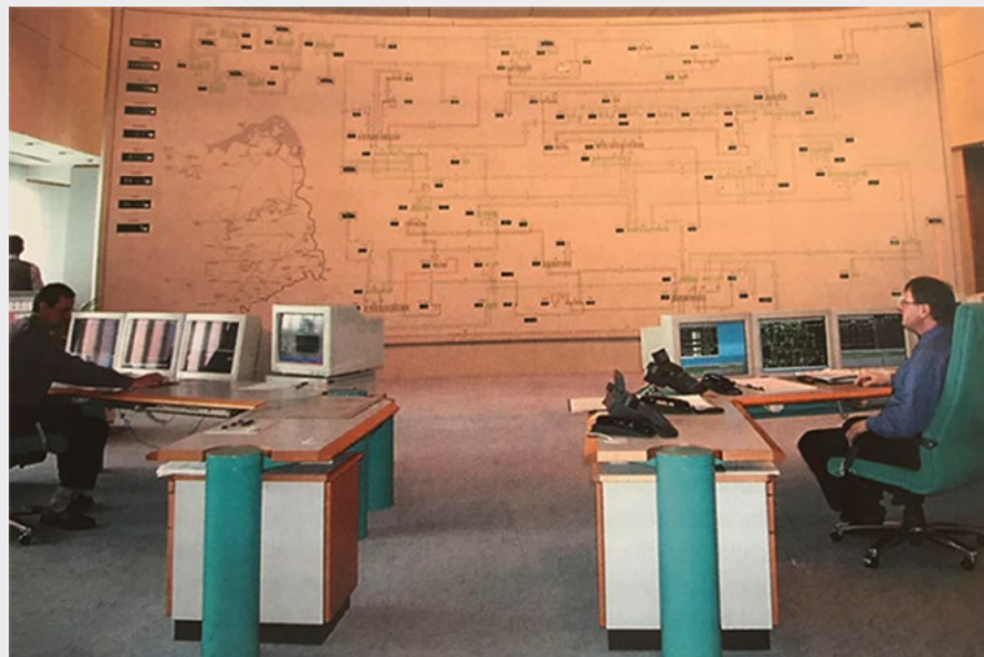
Bild 9: Zentrale Steuerungsstelle der VEAG (Berlin, Beilsteiner Str. 115)
