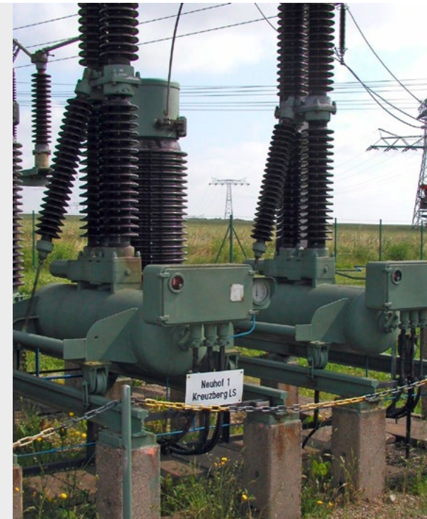
Bild 8: UW Wolkramshausen, 110-kV-Schaltfeld Neuhof 1
