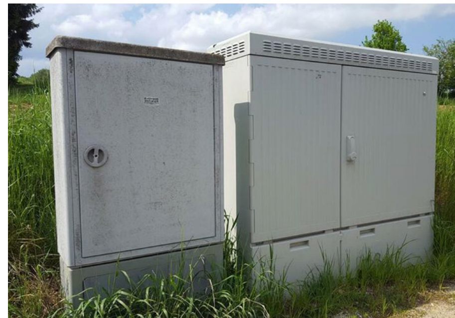
Kabelverzweiger der Telekom
