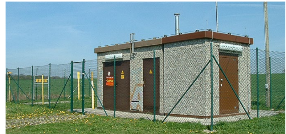
Bild 4: Gasregelanlage (Quelle: Archiv TEAG)
