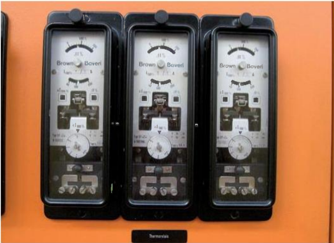
Bild 8: Thermisches Überstromrelais ST, BBC
